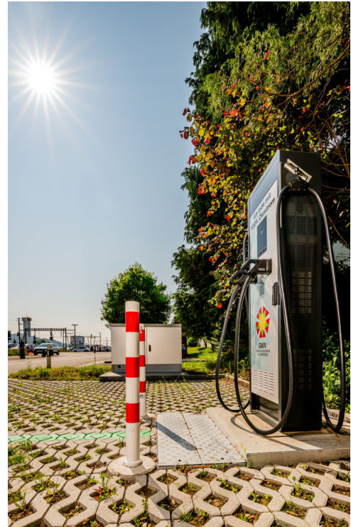
Schnellladestation Bahnhof Ballygebiet
