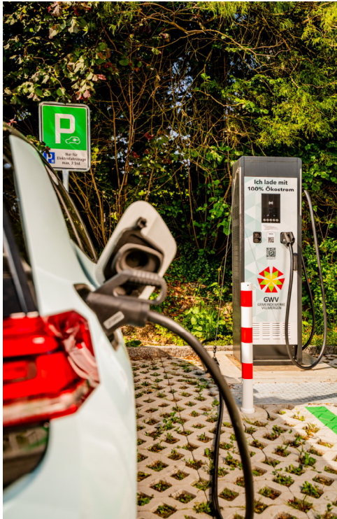
Schnellladestation Bahnhof Ballygebiet
