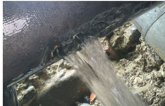
Rohrbruch Mittlerer Talackerweg
