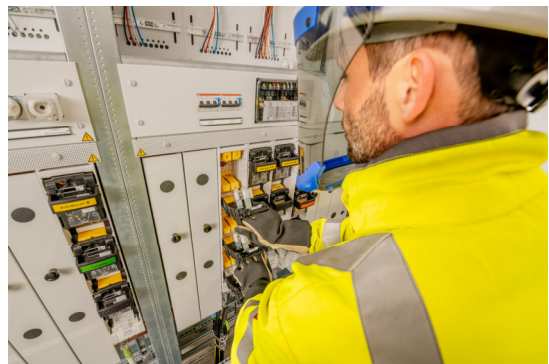
Schalthandlung Niederspannung mit persönlicher Schutzausrüstung, Benjamin Lütolf
