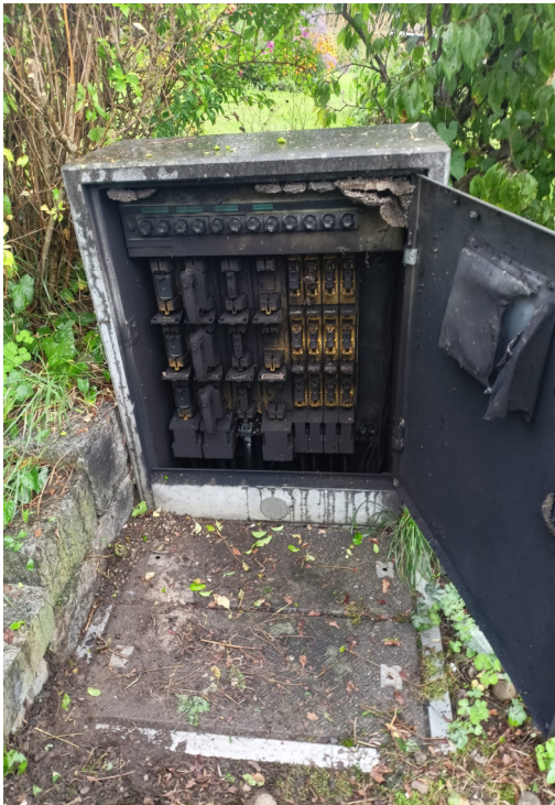
Kurzschluss in Verteilkabine
