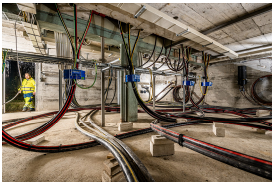
Kabelkeller TS Allmend, Haupteinspeisestation
